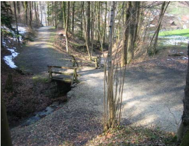
Nr. Silberbach (29.5) (Planbezug): Blick Gerinne abwärts Inhalt: Durchlass unter Forststrasse. Verklausungsgefahr.
