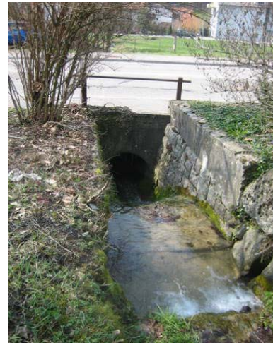
Nr. Silberbach (29.1) (Planbezug): Blick Gerinne abwärts Inhalt: Durchlass unter Reppischtalstrasse. Ungenügendes Schluckvermögen.
