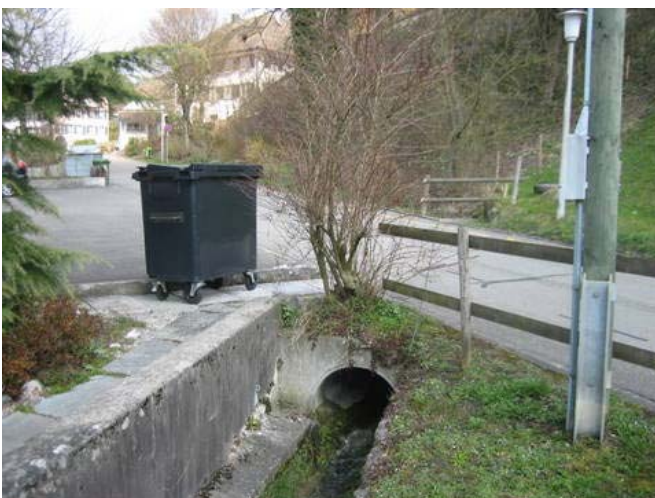
Nr. Silberbach (29.11) (Planbezug): Blick Gerinne aufwärts Inhalt: Durchlass unter Dorfstrasse. Ungenügende Abflusskapazität.
