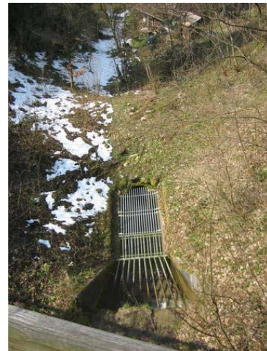
Nr. Silberbach (29.6) (Planbezug): Blick Gerinne abwärts Inhalt: Gerinneeinlass mit Gitterrost. Verklausungsgefahr.
