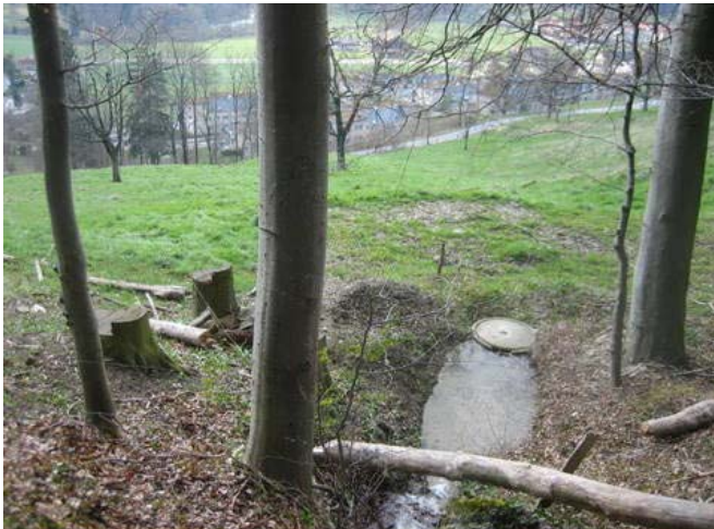
Nr. Langfurenbach (27.5) (Planbezug): Blick Gerinne abwärts Inhalt: Eindolung beim Chüeberg. Verklausungsgefahr.
